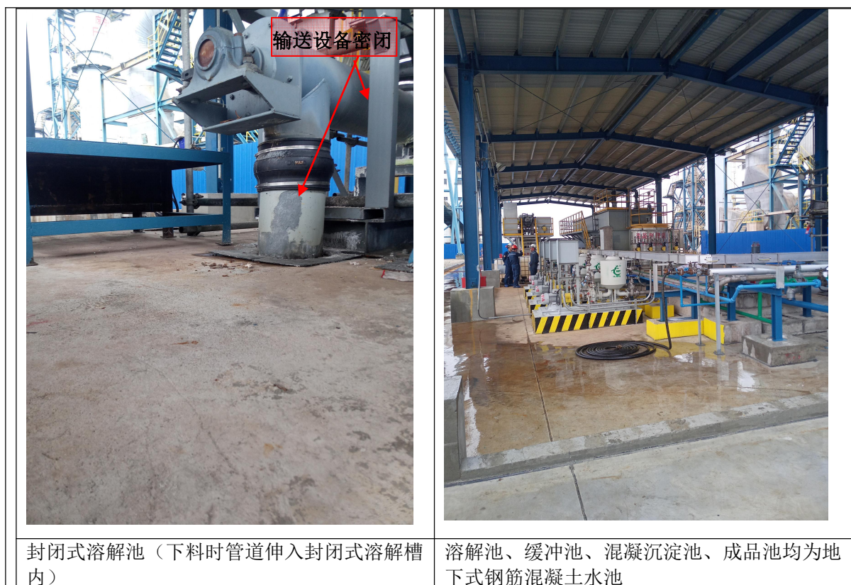
图 3-1 项目废气防治措施现状图片
